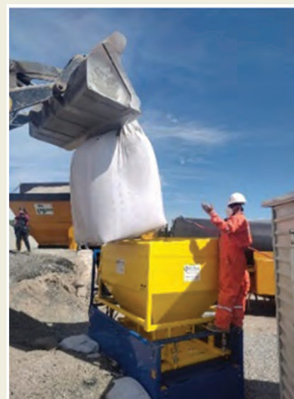
Figura 4. Tolva para incorporación de Tuzaflex RR+30.
